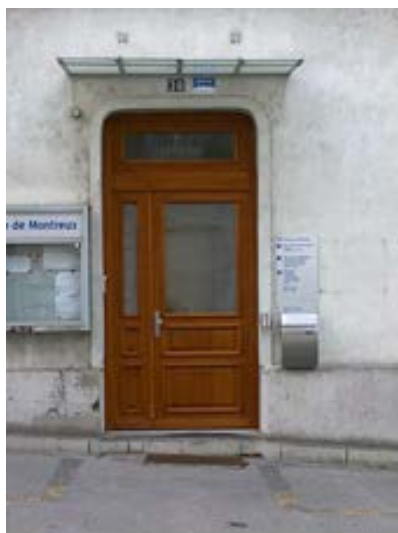
Rue de la Gare 30, à Montreux Remplacement de la porte d'accès principale de l'immeuble
