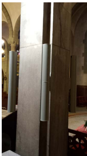
Eglise catholique de Montreux Remplacement de l'installation de sonorisation de l'église
